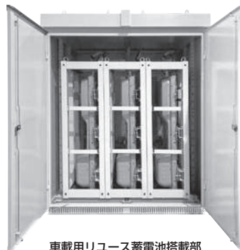
車載用リユース蓄電池搭載部
