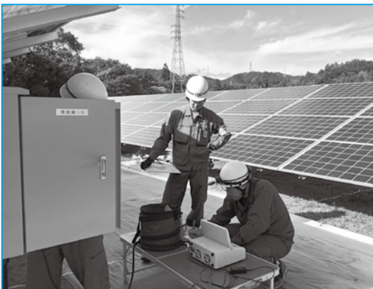
太陽光発電所の保守管理業務。太陽光パネルをはじめ、架台、集電箱、PCSなど多種多様な設備を管理するマルチスキルが求められる。
