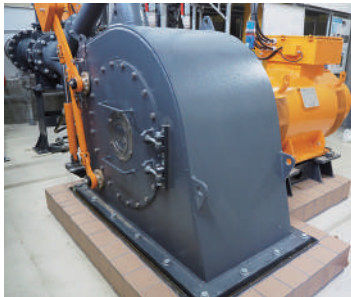
福井県坂井市市川上小水力発電所 (横軸 2 射式ペルトン水車 130 kW・ 2021 年 8 月運転開始)
