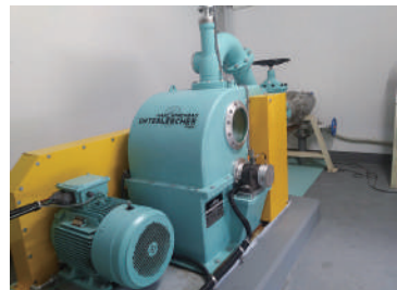
▶ 長野県細ノ洞発電所 (横軸 2 射式ペルトン水車 49.5 kW・ 2021 年 1 月運転開始)
