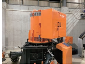
鹿児島県さつま町泊野川水力発電所 (立軸4射ペルトン水車 530 kW・2022年3月運転開始)
