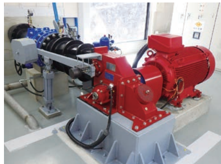
超高落差153mでのクロスフロー水車 導入事例 神坂霧ヶ原小水力発電所(170kW)：2020年4月運開
