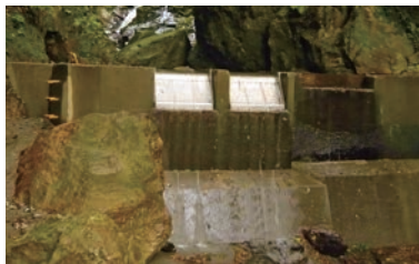
2020年 JJS-A-45LA(2基) 静岡県沼津市
