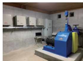
黒土川小水力発電所建屋内 (パワコン出力9.9 kW×4台、PMG同期発電機とペルトン水車39.6 kW 2023年3月運転開始)
