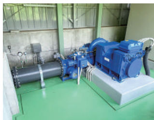
猿倉発電所 水車発電機
