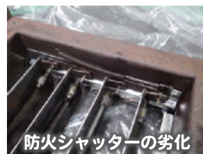
温度ヒューズの破損
